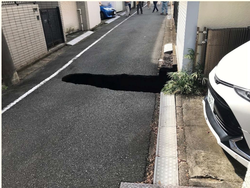
陥没事故現場 (出典: NEXCO東日本)
